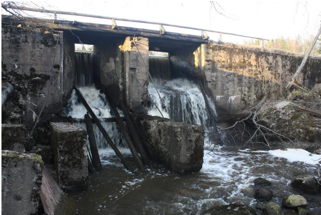
Kuva 19. Dammenin kaksiaukkoinen pato (9e1)- kuva on vanha, kuvauspäivä 24.4.2009, nykyisin pato on selvästi rapistuneempi ja betoniosat enemmän halkeilleita. (AJ)
