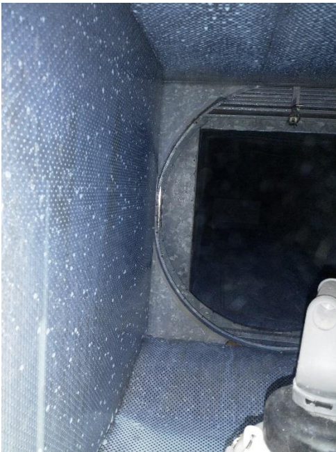
Kuva 3. Koneen jälkeinen tuloilmakanava Grafoseal käsiteltynä
