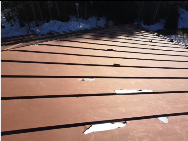
Vanhan osan peltikatteen maalipinnoite on paikoin irronnut.
