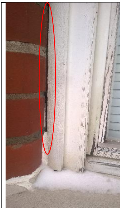
Vanhan puolen ikkunapuitteissa seinän ja listan välissä rako, jota ei ole tiivistetty ulkopuolelta.
