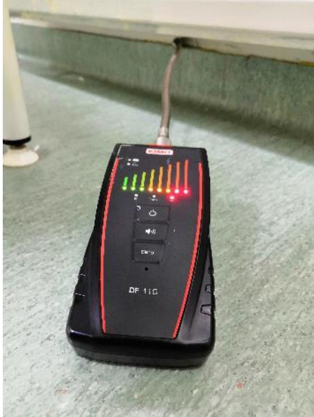
Hammashoitolan lattiarajan pistemäinen vuoto.
