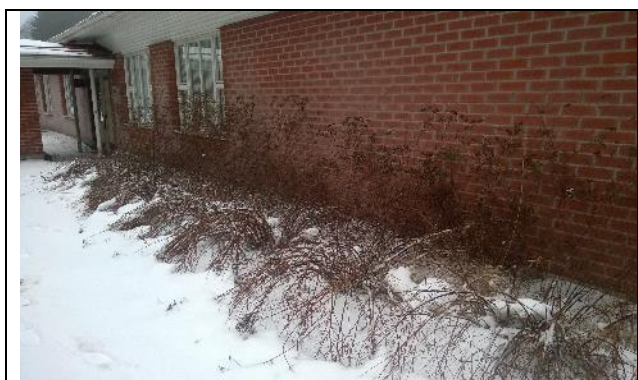
Pensaita on paikoin liian lähellä sokkelilinjaa.
