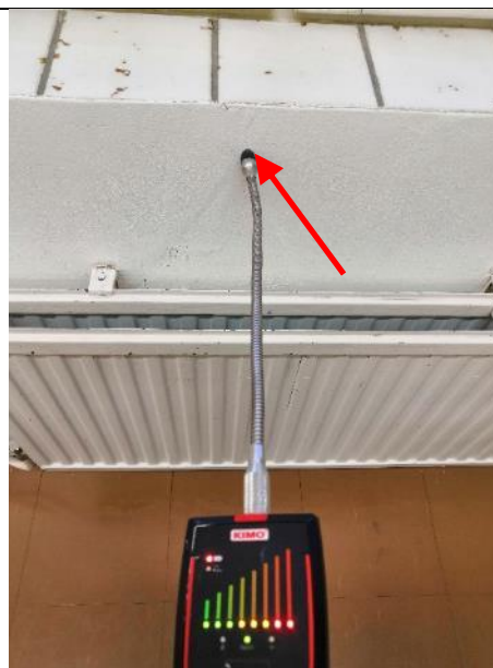
Tila 233, merkittävää ilmavuotoa betoniseinän halkeaman kohdalla.
