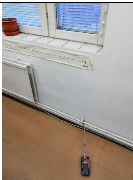
Tila 233, merkittävää ilmavuotoa kannakkeen kohdalla.
