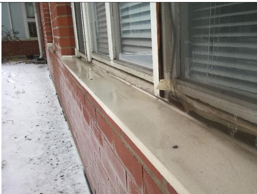
Ikkunapellitykset ovat vanhalla puolella lähes tai kokonaan vaakatasossa. Ikkunoiden alapuitteisiin kohdistuu kosteusrasitusta. Ikkunapellit on kiinnitetty tiivisteettömällä ruuveilla.
