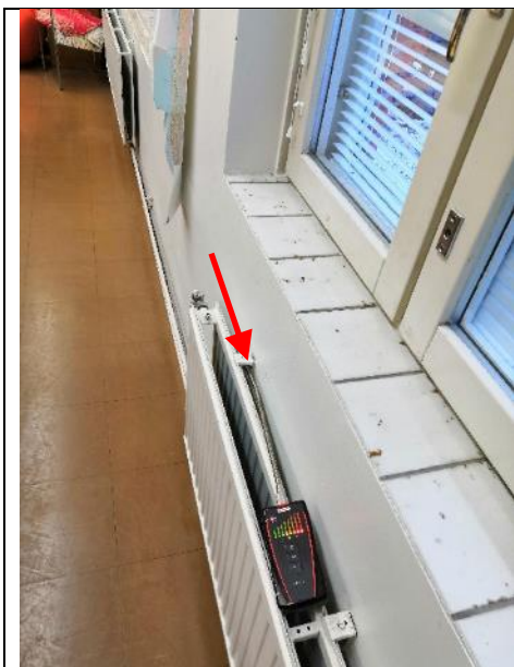
Tila 233, merkittävää ilmavuotoa patterikiinnikkeiden kohdalla.
