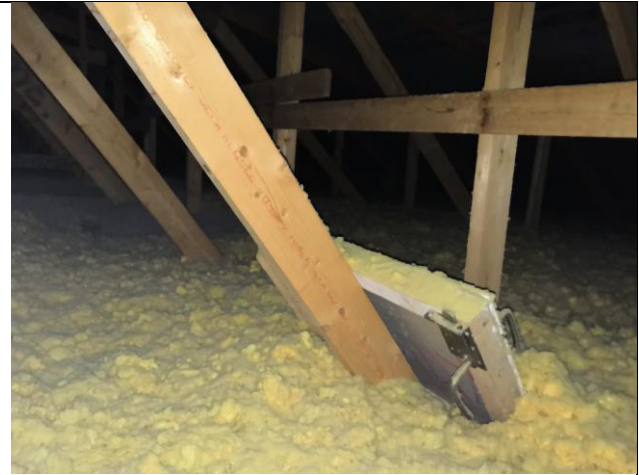
Yläpohjaa palo-osastoiva luukku on irrallaan uudella osalla.
