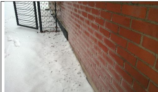
Patolevyssä on epäjatkuvuuskohtia.
