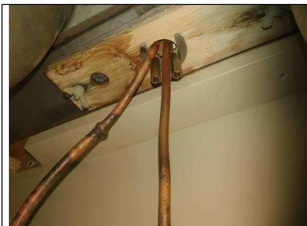
Tilassa 203 hanan kiinnityspuu kastunut.
