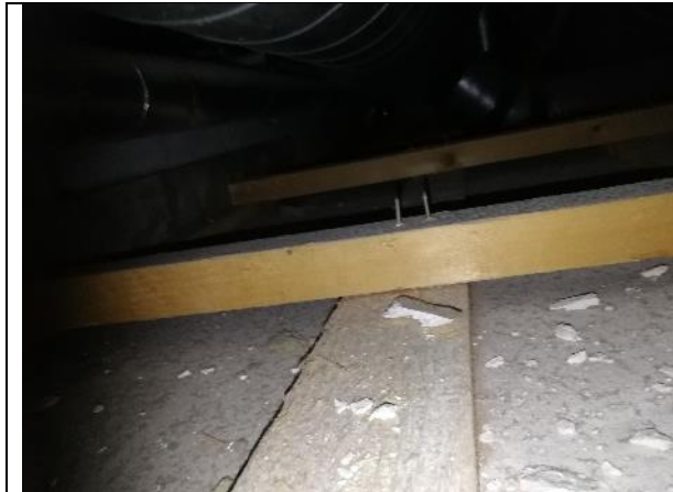
Alaslaskettujen kattojen pinnoilla runsaasti pölyä. Kiinnitykset nauloilla.
