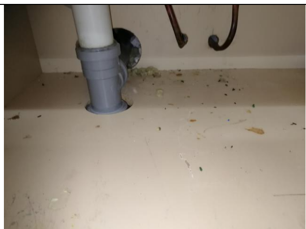
Allaskaapissa merkkejä jrsijöiden läsnäolosta.
