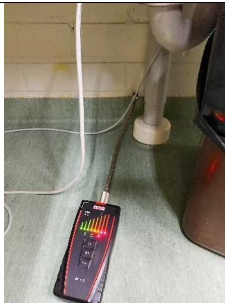
Pistemäisiä vuotoja hammashoitolan lattiarajassa. Havaintojen mukaan lattiamaton seinänosto vähentää ilmavuotoja seinän ja lattian liitoksessa, mutta ei poista niitä kokonaan.
