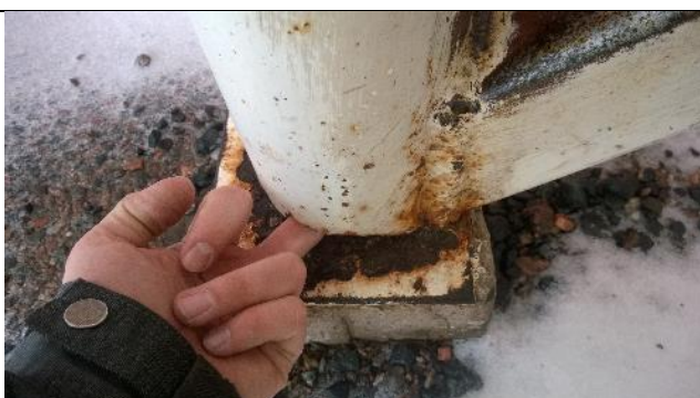
Pilarin liitos pilariperustukseen on heikentynyt.
