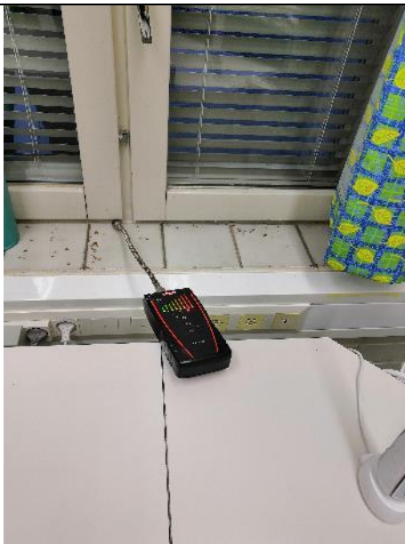
Hammashoitolan ikkunan ja seinän liitoksessa ilmavuotoa.
