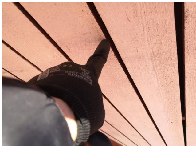
Vanhalla osalla räystäslautojen välit ovat hyvin kapeat ja tukkeutuvat helposti. Tämä heikentää yläpohjan tuulettuvuutta.
