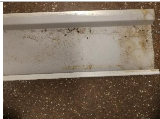
Jyrssiöiden jätöksiä alaslasketun katon metallisäleissä.
