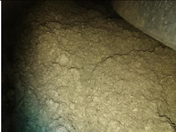
Vanhan osan yläpohjaan on muodostunut suuri määrä jyrstöjen polkuja puhallusvillaan.
