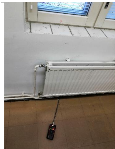
Tila 233, merkittävää vuotoa lattiarajassa.
