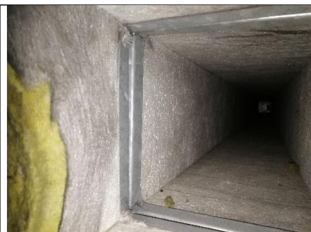
Villalla vuorattua kanavaa tilassa 203.
