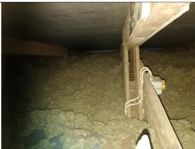
Vanhalla osalla tuulettuva tila räystäään suuntaan jää paikoin matalaksi.
