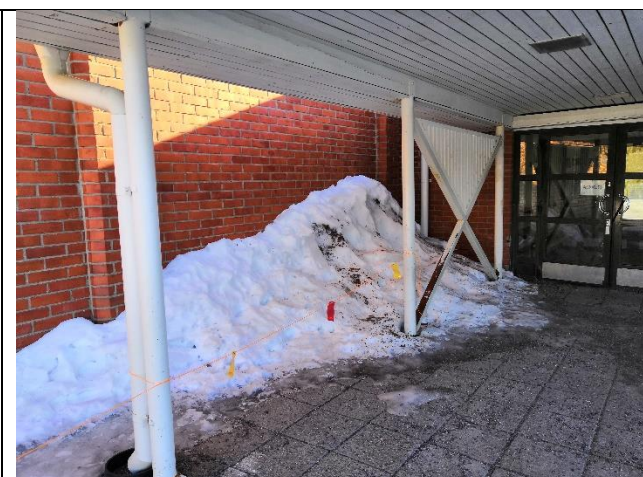
Tuulettumattomaan tiili-villa-tiili -rakenteeseen kohdistuu paikoin huomattavaa ulkopuolista kosteusrasitusta.
