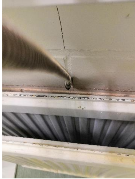
Hammashoitolan seinän halkeamassa merkittävä ilmavuoto.
