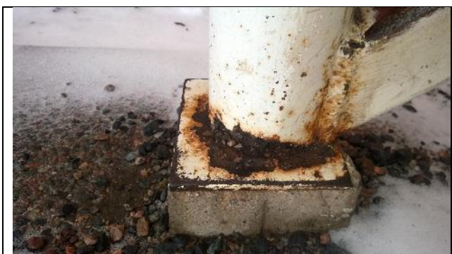
Teräspilareissa ei ole vedenpoistoreikiä. Osa pilareista on alaosastaan puhkiruostuneita.
