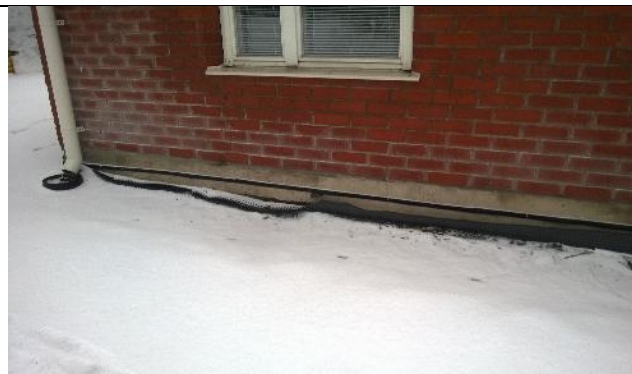
Patolevy on vikaantunut ja ohjaa sadevettä sokkelia vasten.
