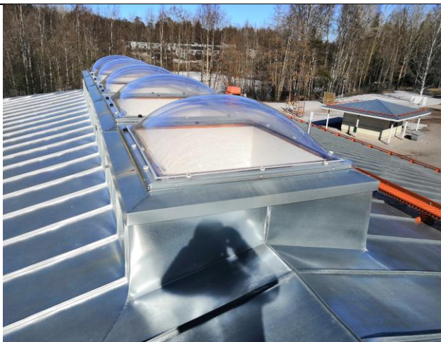
Uudella puolella vesikate on hyväkuntoinen. Kattoikkunoiden kiinnikkeistä puuttuu kumitulppia.
