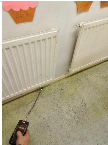
Tila 135, merkittävää ilmavuotoa seinän ja lattian liitoksessa.
