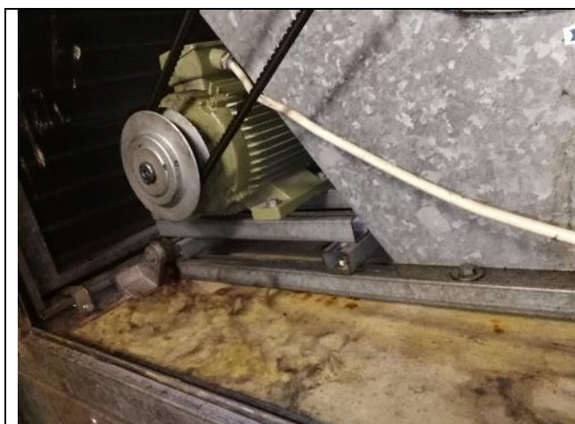
Villaeristeet rikkoontuneet puhallinkammiossa luokkatiloja palveleva iv-kone.
