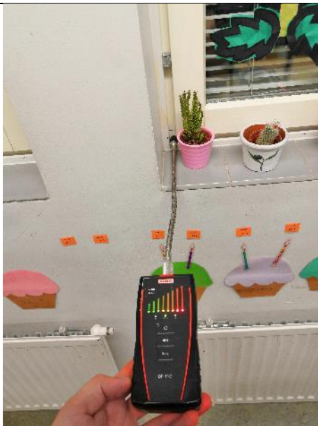
Tila 135, merkittävää ilmavuotoa ikkunan ja seinän liitoksessa.
