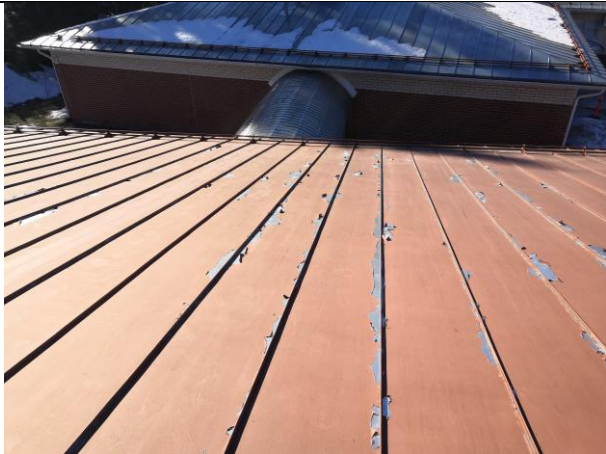
Vanhan osan peltikatteen maalipinnoite on paikoin irronnut.
