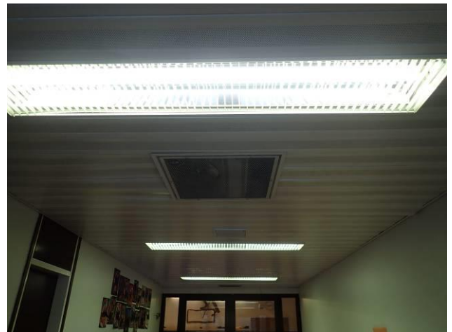
Sisäänkäynnin alkuperäiset loisteputkivalaisimet ovat jo ikääntyneitä(vanha siipi)
