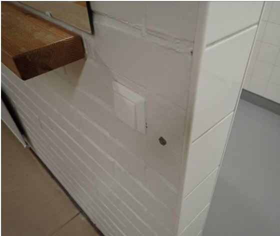
Uusittu kytkinkaluste pukeutumistilassa (vanha siipi)
