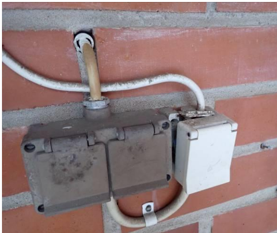
Ulkoseinän pistorasia on irronnut alustastaan. Käyttöeristetyt johtimet kosketeltavissa sähköturvallisuusmääräysten vastaisesti.
