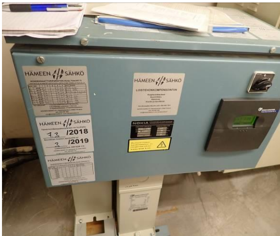
Alkuperäinen kompensointiparisto pääkeskuksissa
