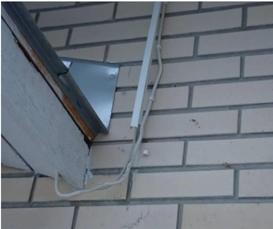
Sisäänkäynnin luona ulkoseinällä kaapelien kiinnitykset puutteellisia
