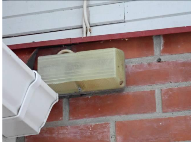
Ulkoseinävalaisimen kupu on kellastunut.
