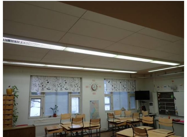
Luokkahuoneen pinta-asennetut loisteputkivalaisimet alkuperäiseltä rakentamisajankohdaltaan (vanha siipi)
