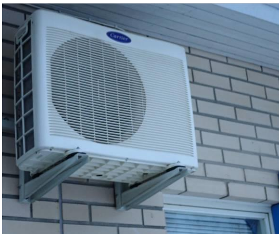
Rakentamisajankohdan jälkeen on lisätty ilma- lämpöpumppu (uudempi siipi)
