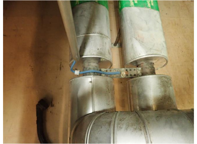
Putkistot yhdistetty maadoitusvanteella.
