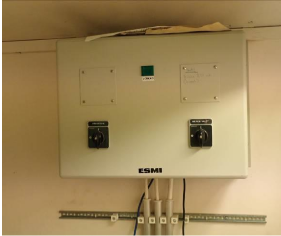
Esmi alkuperäinen turvavalokeskus sijaitsee pääkeskushuoneessa
