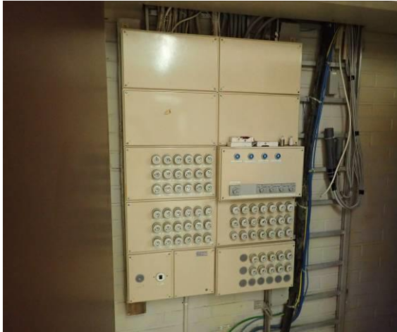
Alkuperäinen tulppasulakekeskus(vanha siipi)
