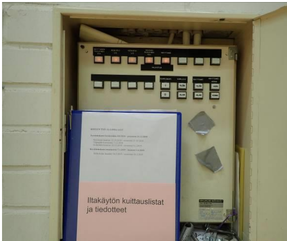
Alkuperäinen valaistuksen ohjauskeskus liikuntahallin puolella on ikääntynyt
