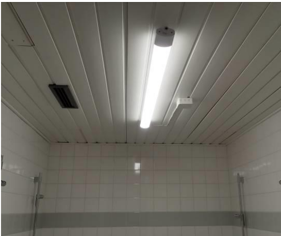
Pukuhuoneen pesutilan uusittu valaisin on hyvä kuntoinen (vanha siipi)
