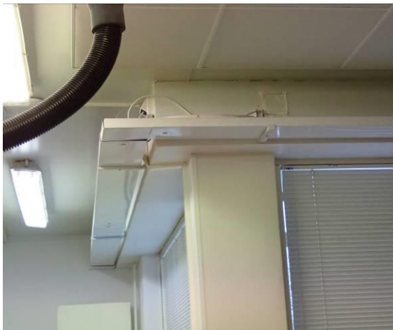
Uudemmassa rakennusosassa on käytetty johtoteinä levyhyllyjä
