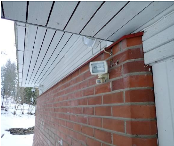
Rakentamisajankohdan jälkeen asennettu liike-tunnistimella toimiva valonheitin ulkoseinällä
