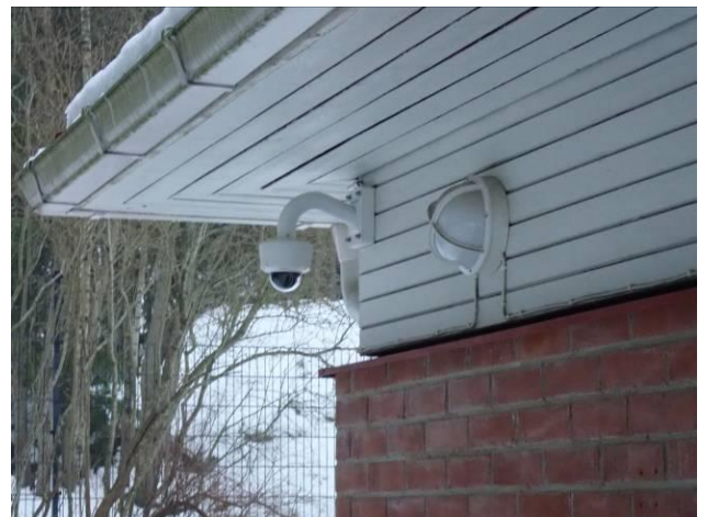
Kiinteistössä on kameravalvontajärjestelmä
