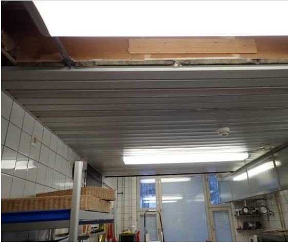
Keittiötilan valaistusta (vanha siipi)
