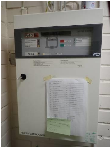
Paloilmoitinkeskus sijaitsee teknisessä tilassa (vanhempi siipi)
