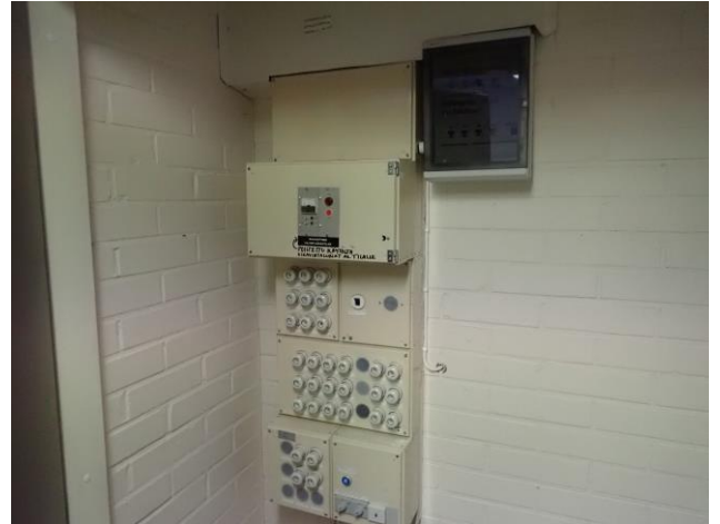
Hammashoitolan siiven ryhmäkeskus, johon lisätty uusi lisäosa vikavirtasuojakytkimiseen
