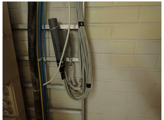
Sähkökomerossa käytävällä sijaitsee puhelinjatkos/haaroitustuppi.....
