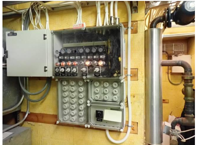
Alkuperäinen lv-keskus lv-konehuoneessa (vanha siipi)
