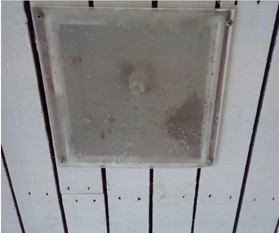
Sisäänkäyntikatoksen alkuperäinen säästölam- pulla toimiva valaisin. Valaisin on ikääntynyt
