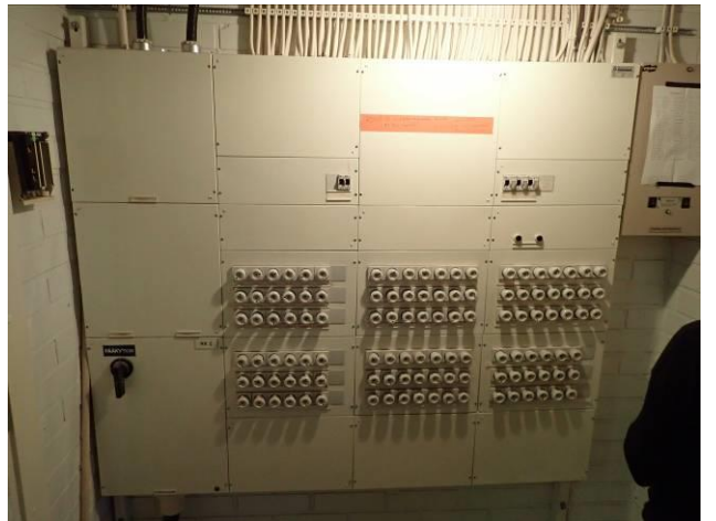
Uudemman rakennusosan yhdistetty nousukeskus NK ja ryhmäkeskus vuodelta 1993
