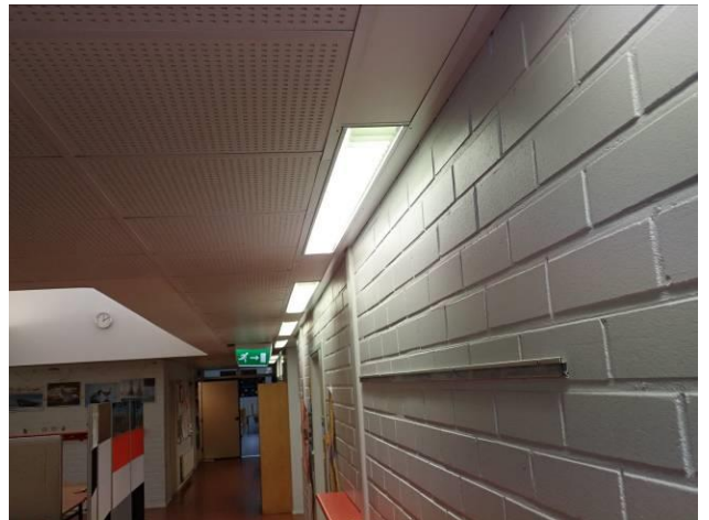
Käytävän valaistusta (uudempi siipi)
