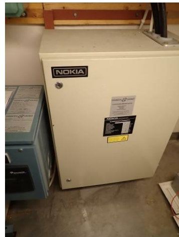
Myöhemmin lisätty/uusittu kompensointiyksikkö
