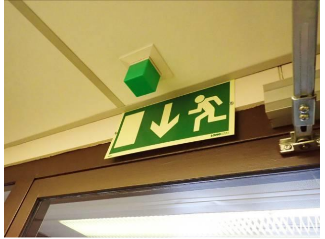
Ikäännytynyt hehkulampputyypinen poistumistievalaisin on pimeänä(vanha siipi)
