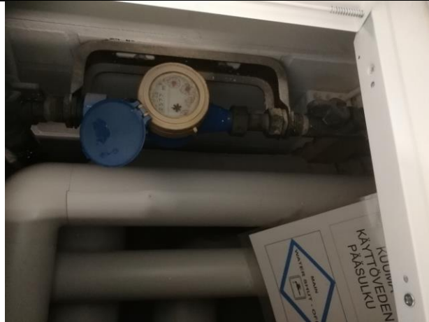
Toinen vesimittari uudella osalla.
