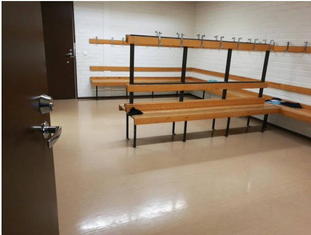
näyte 4 pukuhuoneen lattian muovimatto, liima ja laastit → ei asbestia
