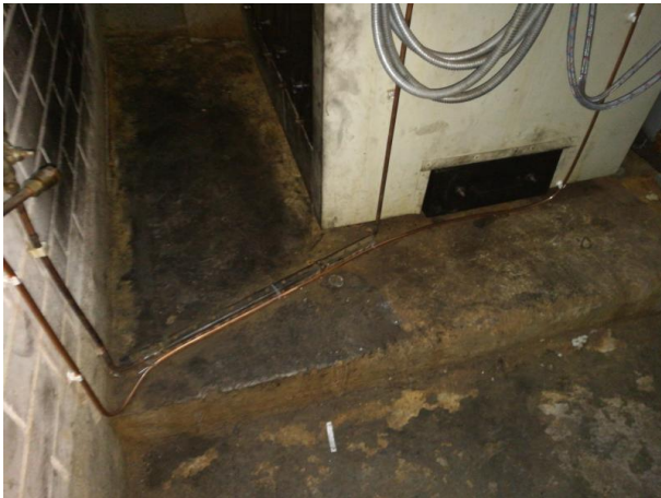
lämmönjakohuoneen lattialla öljyä
